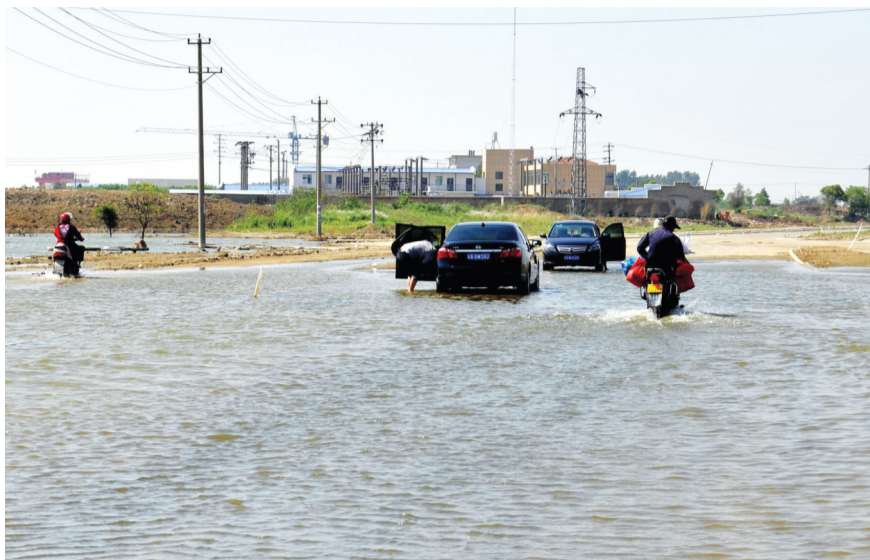
原本计划2013年8月25日就完工的合肥金斗路，如今处于半停工状态，近百米的路面泡在水中，很多车辆在此“洗澡”。行人、车辆只能蹚着水过，稍有不慎就会人仰马翻。 记者 倪路/图
