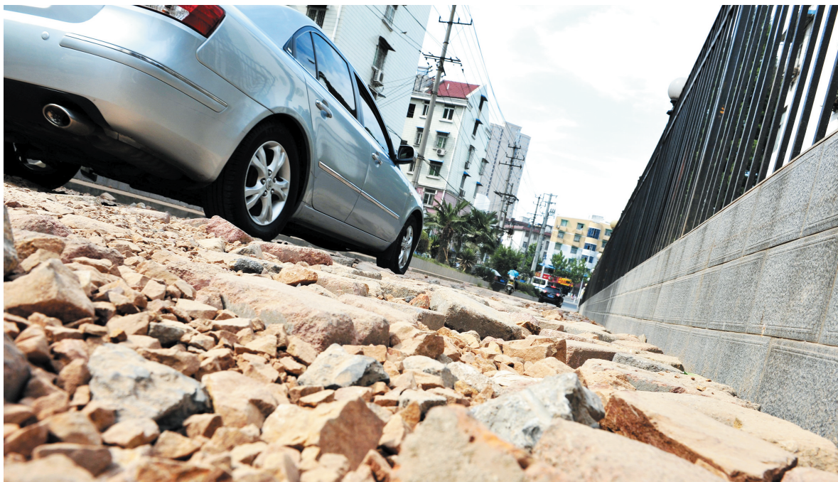
合肥敬亭山路是用地砖铺设而成，因胜利路施工，很多车辆从该处绕行，受大型车辆碾轧，路面高低不平，地砖松动翘起被挤到路边，给过往车辆及市民带来很大安全隐患。
