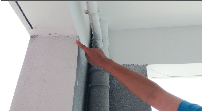
房屋墙体已开裂
