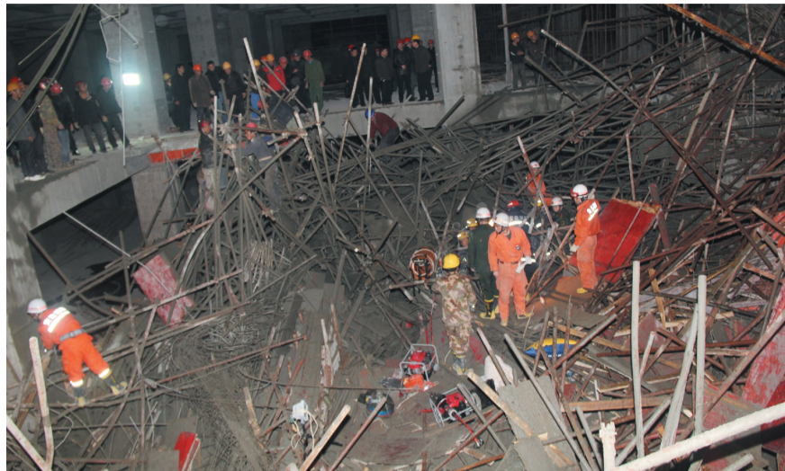
桐城坍塌事故现场(资料图片)
