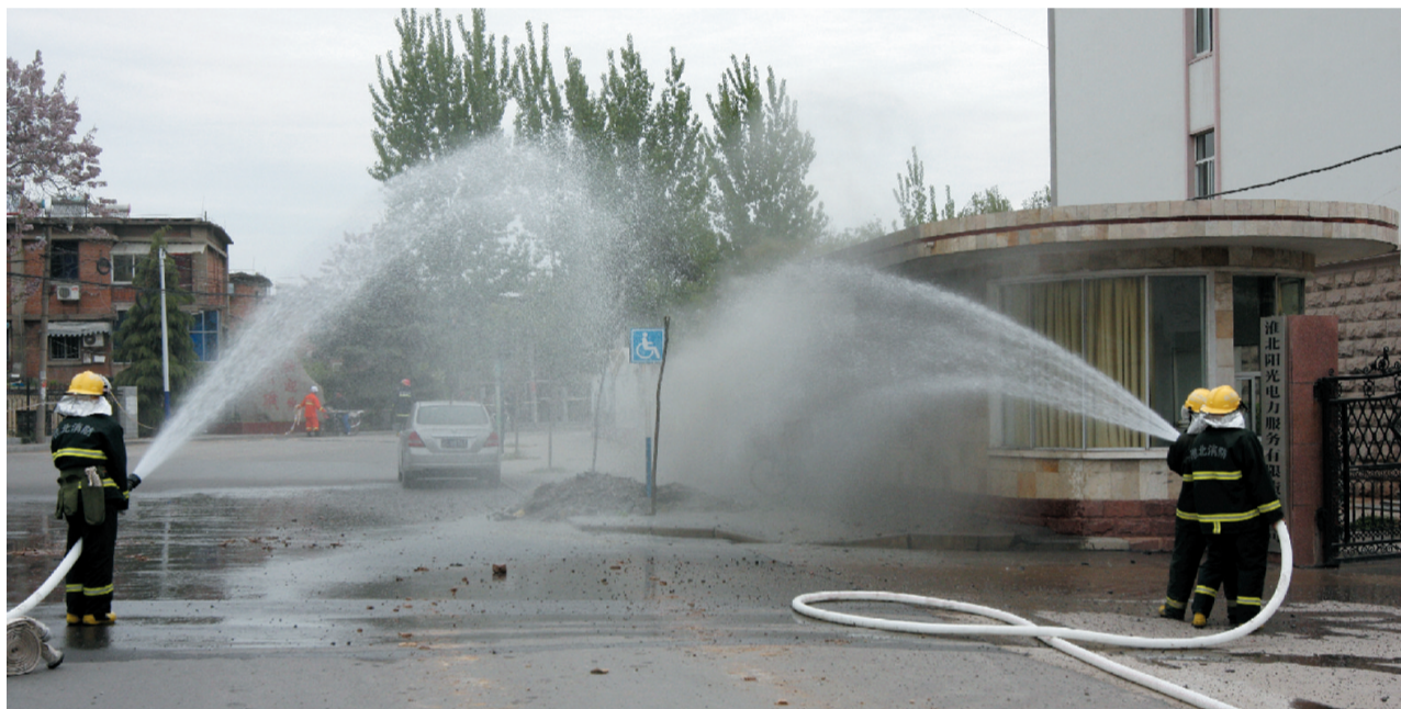
4月19日7时30分,淮北市杜集区淮北阳光电力服务有限公司门前地下天然气管道发生泄漏。由于泄漏地点处于马路旁,人员出入多,车流量较大,一旦发生爆炸后果不堪设想。当地消防迅速调集7辆消防车和30名消防官兵赶到现场进行处置,所幸未造成人员伤亡。事故原因正在调查中。 李小锐 记者 志强 文/图
