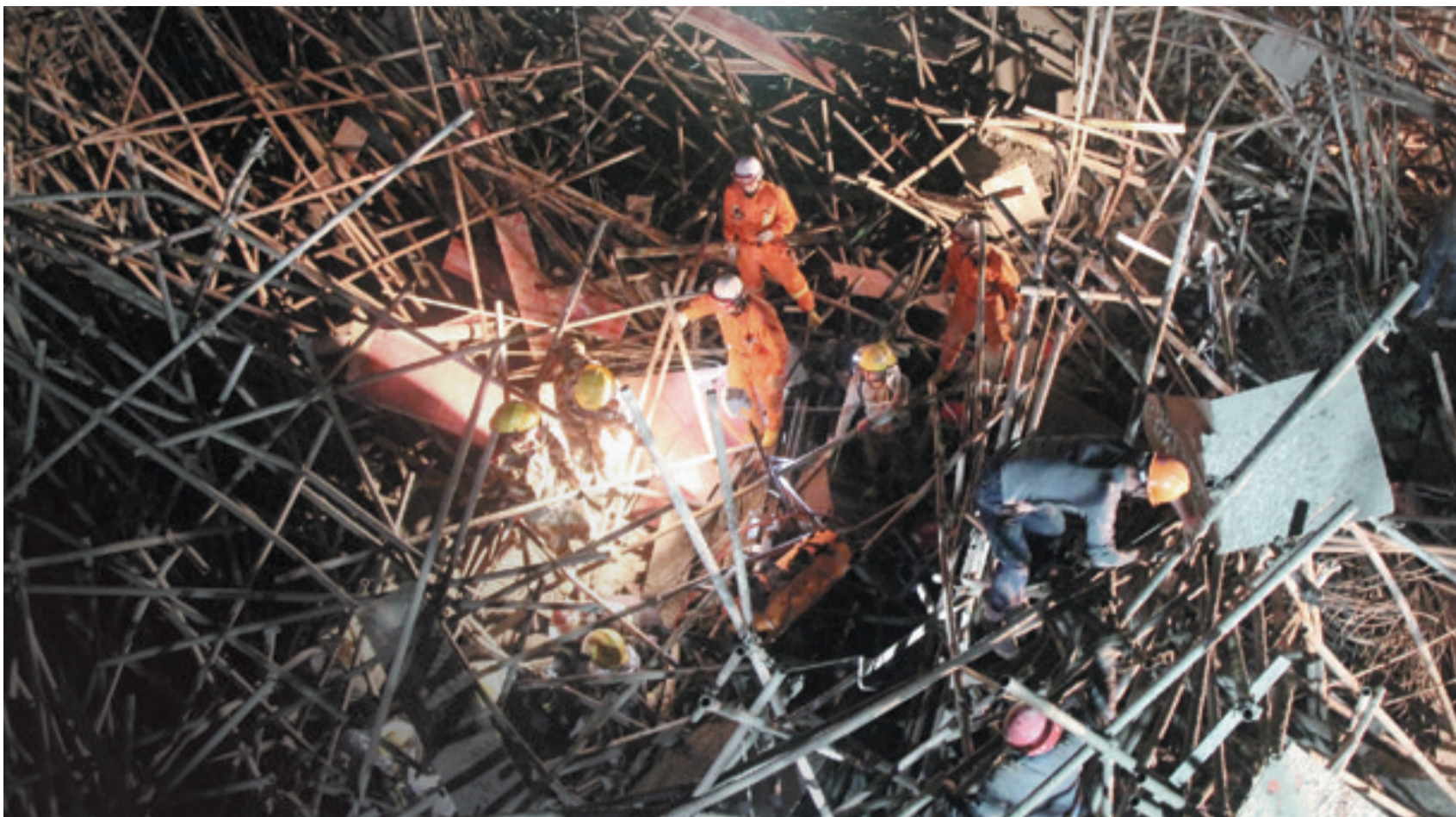
图为坍塌现场
