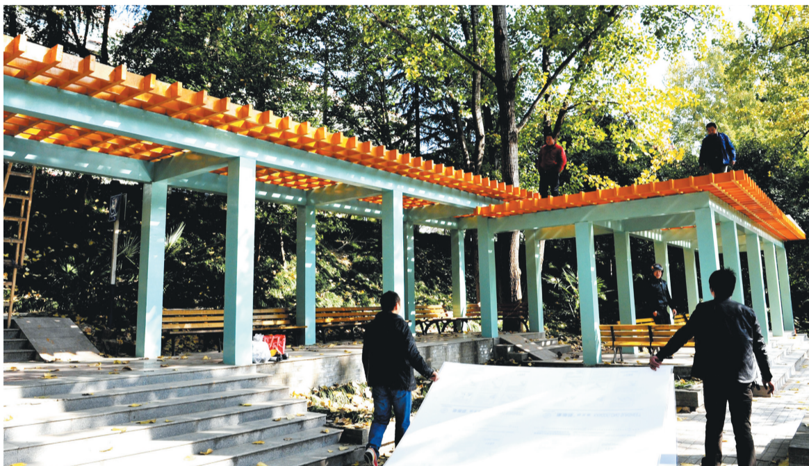
为进一步完善环城公园人文景观, 合肥园林部门为环北景区的景观凉亭加顶, 以改善雨雪天气市民观光休息。记者 倪路/图
