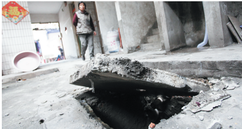
一楼窨井盖被掀开
