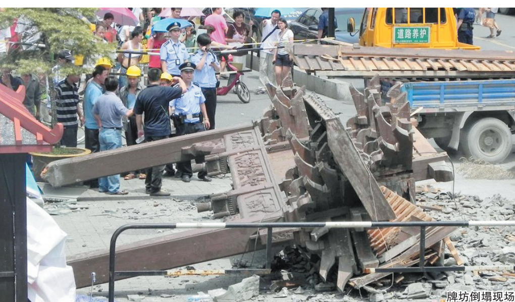
牌坊倒塌现场
