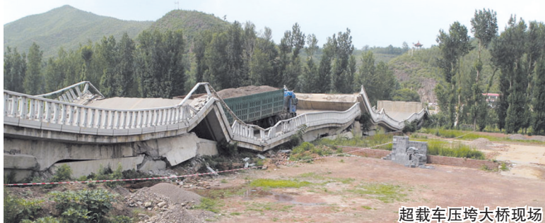
超载车压垮大桥现场
