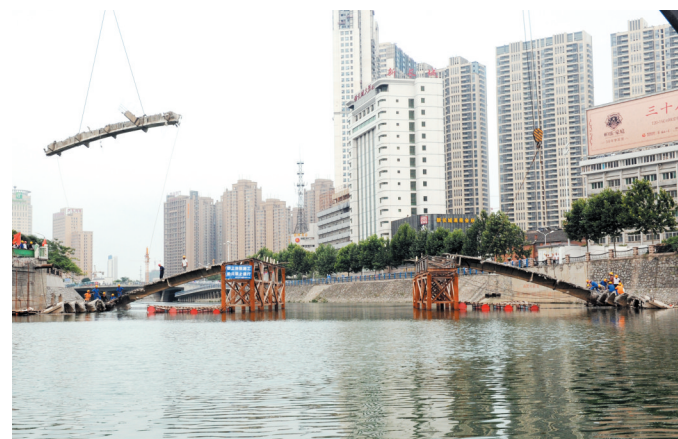
服务了合肥几十年的长江路桥进入最后时刻。昨日下午,记者现场看到,桥体已经拆除完毕。拆下来的部分也即将运送出去并销毁。再见未来的新长江路桥也只能等待明年5月底了。
