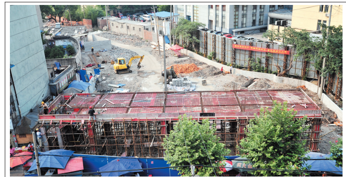
日前,南北贯穿淮河路和寿春路的杏花菜场改造工程开始,现场施工人员正在搭设菜场门头。据了解,改造后的杏花菜场将给市民提供更舒适的购物环境。 记者 程兆/图
