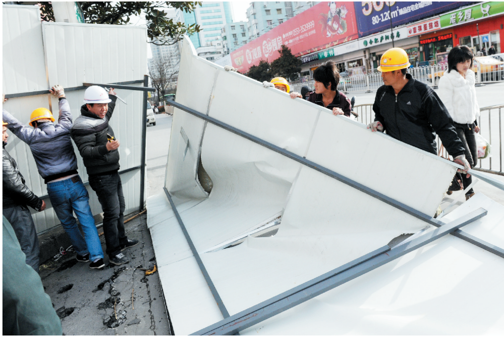
大风吹倒防护板
