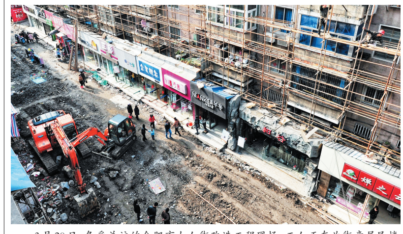
3月20日,备受关注的合肥市女人街改造工程现场,工人正在为街旁居民楼搭建脚手架,道路部分也在加紧施工中。据了解,脚手架搭建完毕后,沿街各楼将会被统一粉刷,预计整个外墙亮化工程持续到五月初。 记者 程兆/图
