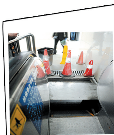
踏板被盗的电梯露出缝隙
