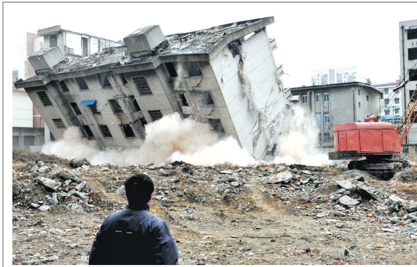
目前，合肥铜陵路高架桥进入全面施工阶段，影响项目建设的住宅、酒店、商场等拆除工作已接近尾声。据悉，铜陵路高架工期为12个月，通车后市民将感受到高架带来的速度。倪路/摄
