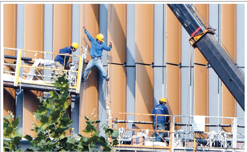
日前, 在合肥市长江路某正在建设的大厦外墙上, 一名工人在两架施工吊车上来回翻越, 虽然吊车之间距离很近, 可在没有安全措施保护的情况下, 还是挺悬的, 不免让人捏把汗。
