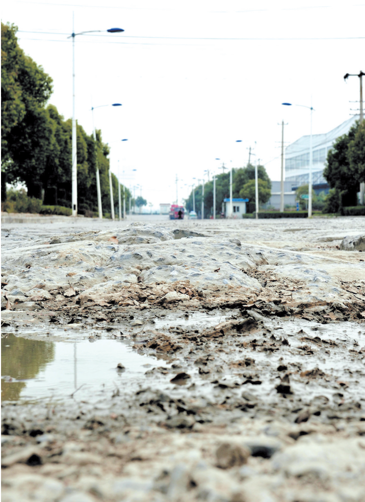
道路上小坑连着大坑
