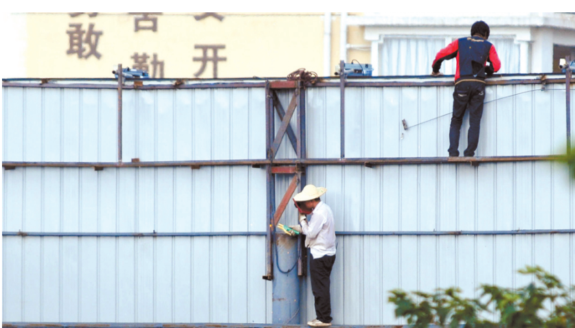
近日,记者在省城清溪路一工地旁看到,两名工人站在高处脚踏钢架,在没有采取任何安全措施的情况下安装广告牌,着实让人捏了一把汗。 记者 黄洋洋/图
