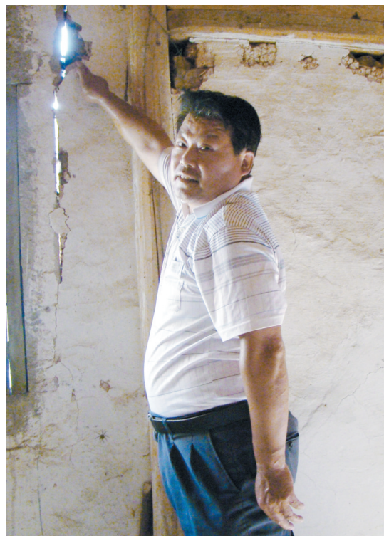
黄良开家楼房被震出的贯穿性裂缝
