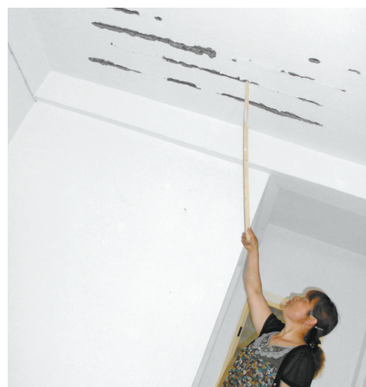
现浇板钢筋露出
