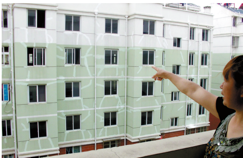
大楼外墙成了“大花脸”
