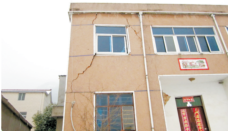
当地被震裂的房屋
