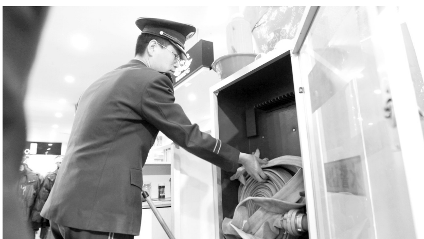
消防人员在检查消防设施
