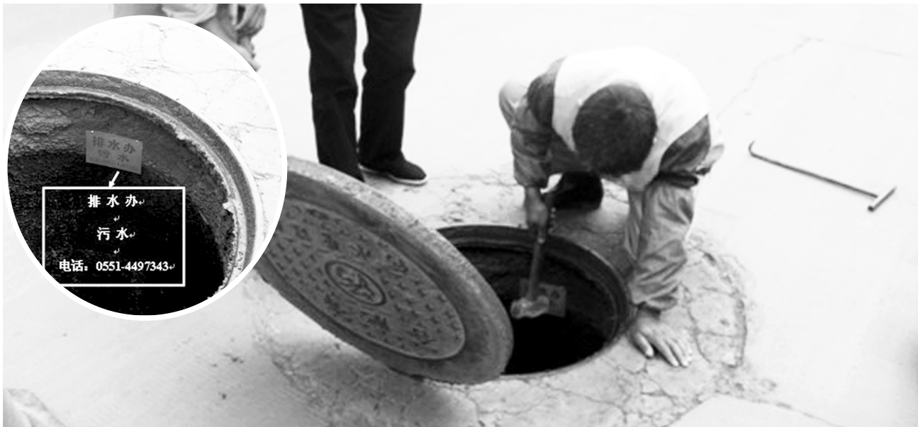
为加强城市道路雨污水检查井的维护和管理,目前合肥市排管办排水所正在组织人员对市级管理的两万多只雨污水检查井安装标识牌。据介绍,安装标识牌的目的就是给窨井安上“身份证”,明确窨井的产权责任单位,在井盖丢失、损坏后方便市民及时通过标识牌所提供的电话,通知产权责任单位,便于责任单位对损坏或丢失的井盖进行维修或更换,保障市民的出行安全。 记者 徐涛文/图
